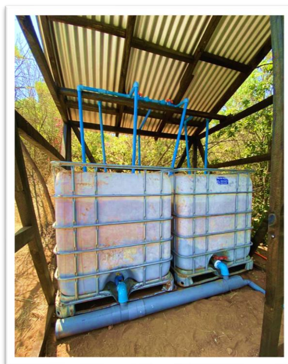
Planta de tratamiento.
